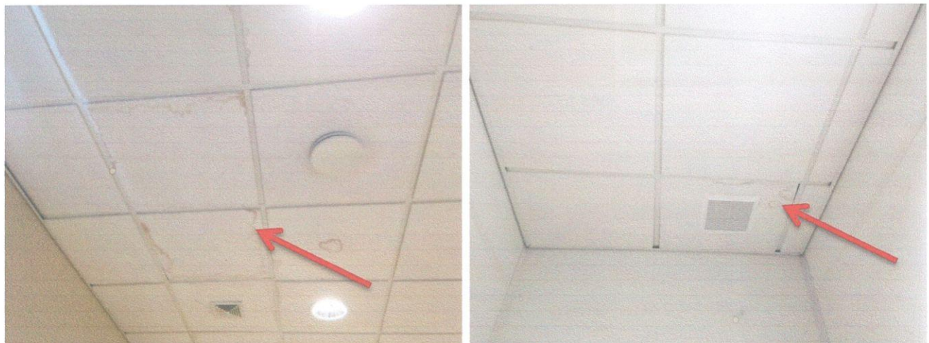
Foto nr.25,26 Kondens. notecējuma pēdas uz iekārto griestu plāksnēm zem ventilācijas sistēmas gaisa vadiem.
