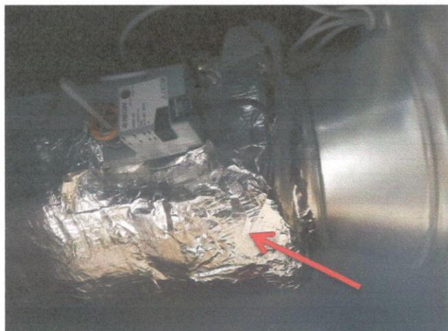
Foto nr.27 Ar vati noizolēts tikai motorizētais vārsts.
