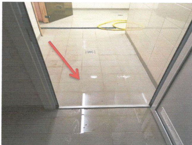
Foto nr.6 Pērtuves priekštelpā nav izveidota ūdens novadīšana uz trapu.
