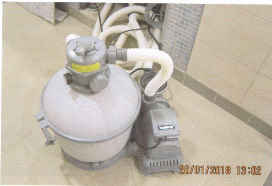
Kanalizācijas izvads, kas nepieciešamas filtra skalošanai nav pievienots un ir slēgts.
